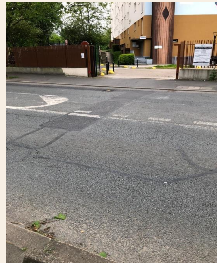
Résidence du Plateau les riverains demande de poser des plots anti-stationnement à côté de l'entrée de résidence (demande en cours auprès des services techniques / traité en urgence)
